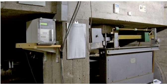
Lysimeteranlage – Waagen von unten
