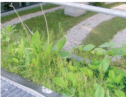
Auf diesem schwerzugänglichen Pflanzkübel konnten sich Unkräuter etablieren. Sie stellen in den relativ kleinen Pflanzkübeln eine
