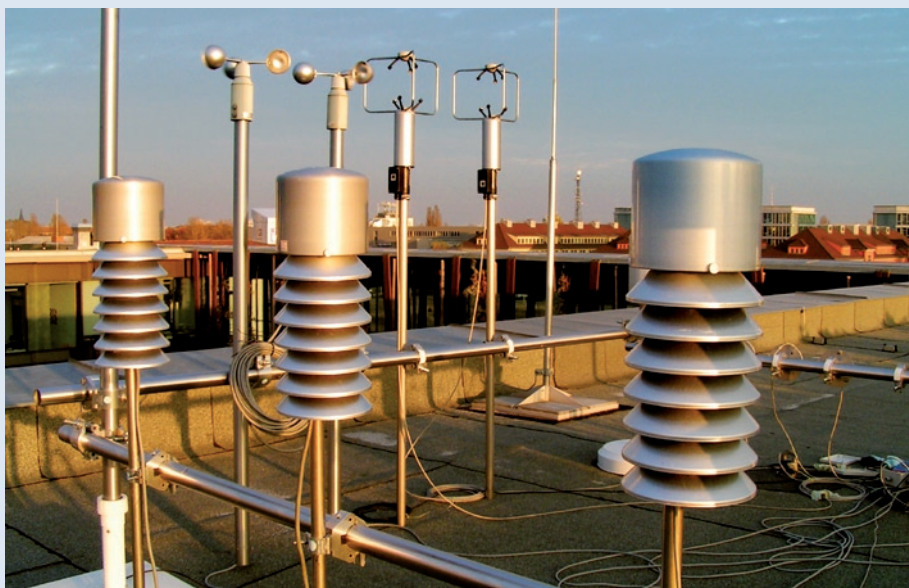
Messensoren auf dem Dach des Instituts für Physik
