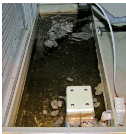
Wanne mit Betriebswasser, über die die adiabate Abluftkühlung zirkuliert, Nachspeiseventil mit mechanischem Schwimmer im Vordergrund, Leitfähigkeitsmessung in der Druckleitung im Hintergrund
