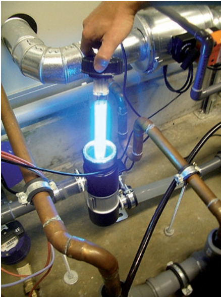
UV-Desinfektion des Betriebswassers
