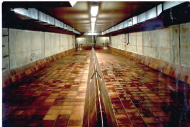
Regenklärbecken. Quelle: Berliner Wasserbetriebe
