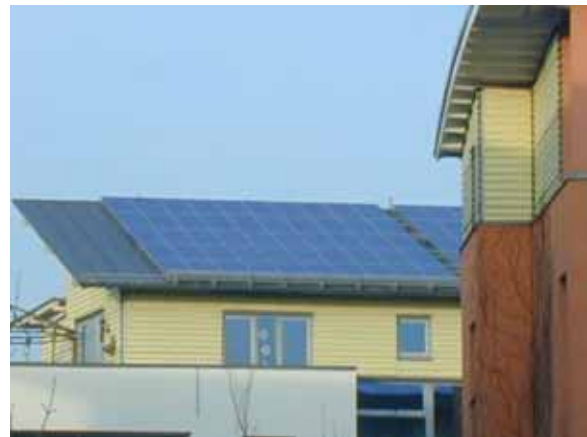
Dach mit Photovoltaikanlage
