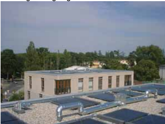
Blick auf die thermische Solaranlage
