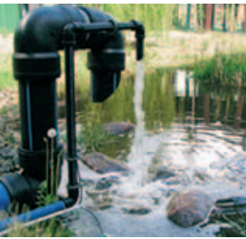
Überleitung von Regenwasser aus den Zisternen
