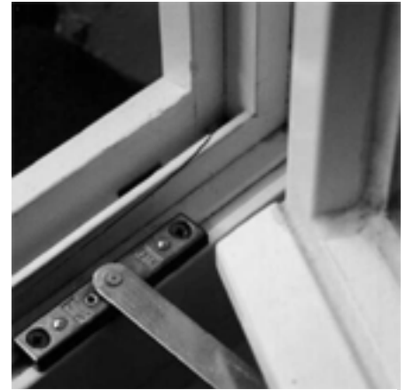
Beschädigung am Rahmen durch nicht nachgestellte Beschläge
