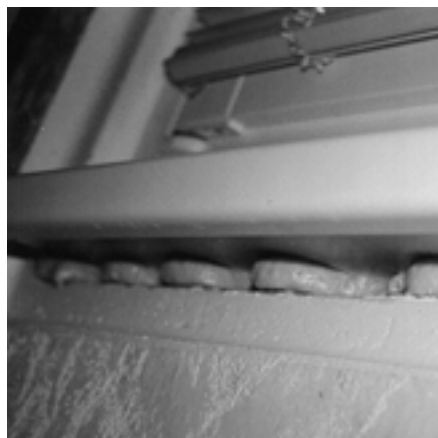
sichtbare Verschämung unter Fensterbrett
