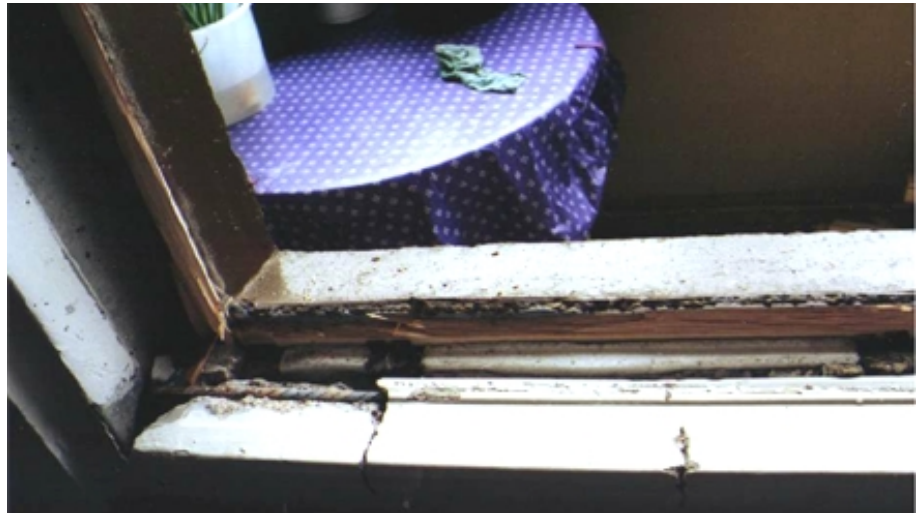
Ausbrüche an der Laibung nach Demontage der Fenster
