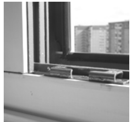
Hängenden Flügel führen zu gerissener Eckdichtung
