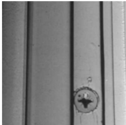
Risse im Lack nach der Befestigung
