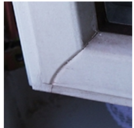
Geöffnete Fuge bei der Zinken-Eckverbindung
