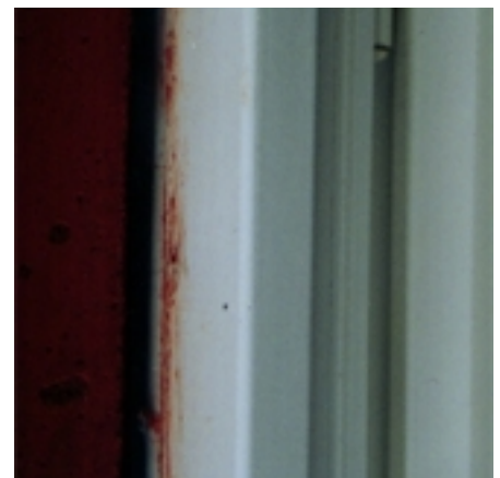
Überstreichung durch Nutzer
