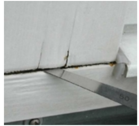
Holzerstörung bei einer Brüstungsfuge an einem Pfosten
